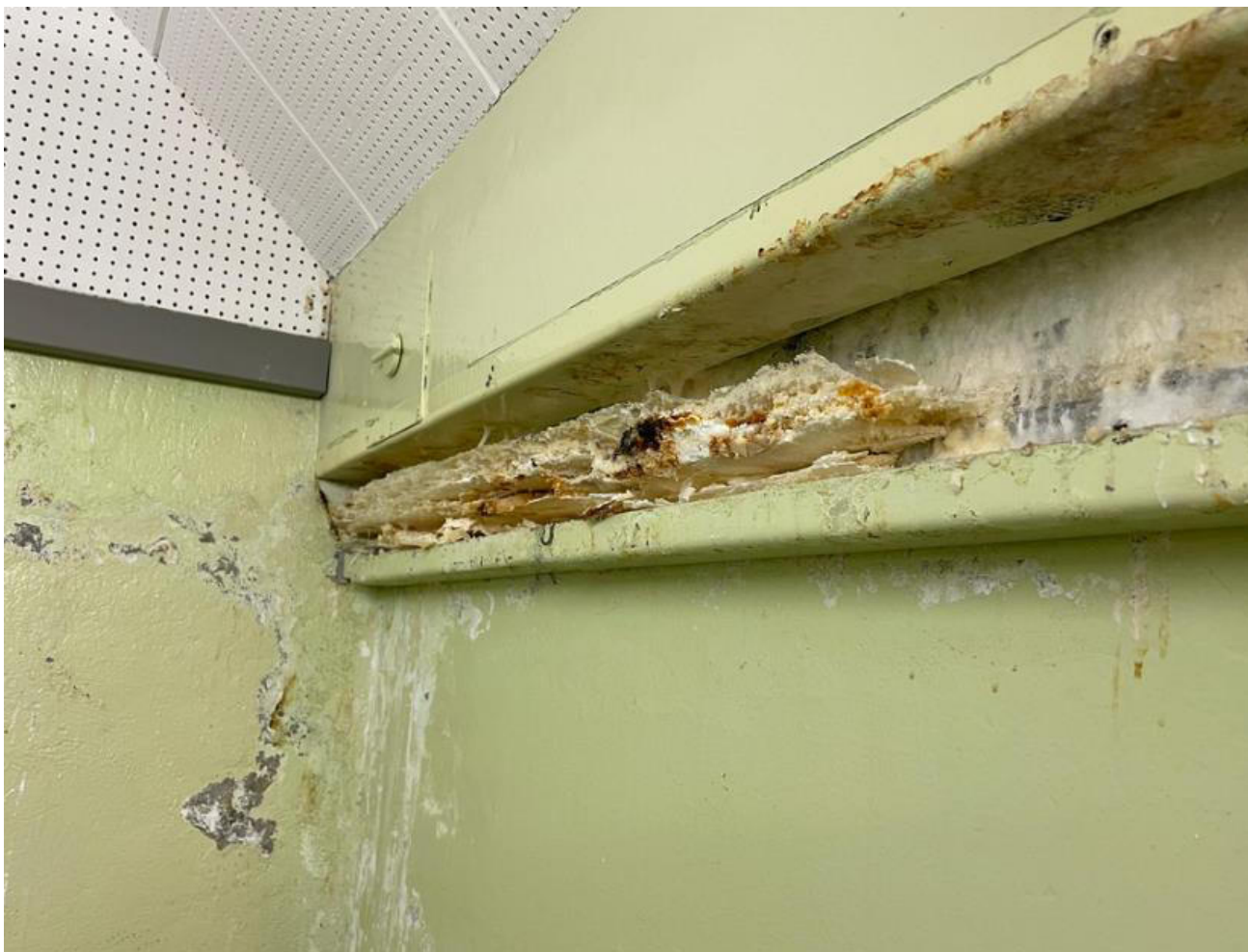
Dans le bureau de tir, une fois les recouvrements ôtés, les cunettes en disent long ...
