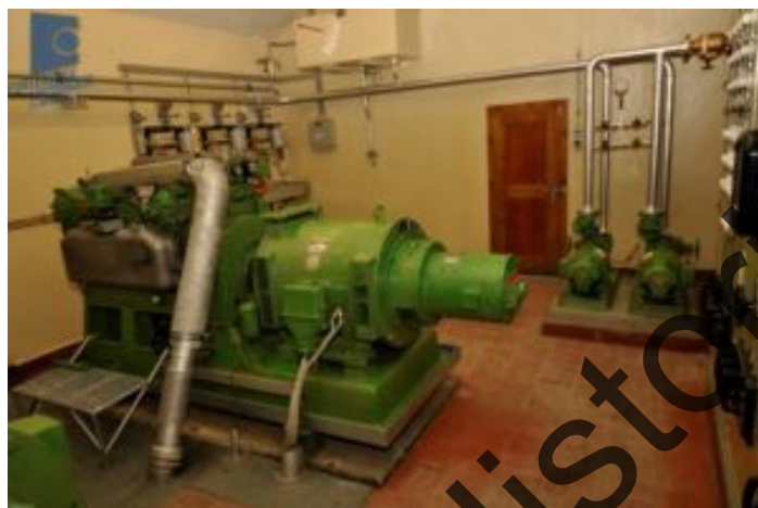
Salle des machines Fort du Scex : 1 des 3 moteurs
