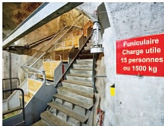
Sous le funiculaire, des tuyaux sont utilisés pour ventiler et alimenter Savatan en eau. Le courant créé en aval fait le chemin inverse. HOFMANN
